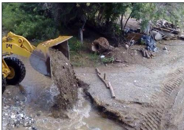
Carretera dañada por las tormentas posteriores al paso del huracán “Patricia” en “Paso San Francisco”.
