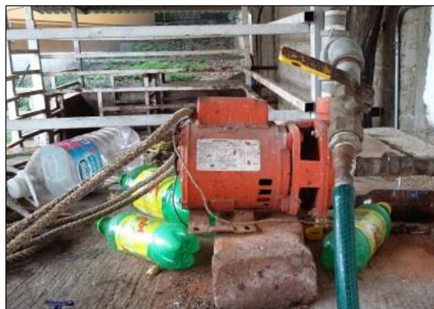
Pésimo cuidado y mantenimiento al equipamiento.
