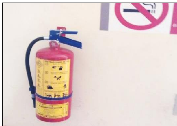
Extintor colocado en la planta alta de la Presidencia Municipal.
