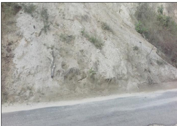
Derrumbe en la carretera.
