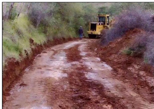
Camino de la localidad de “La Cahuinga” a la localidad de “Gallardo” durante su rehabilitación.
