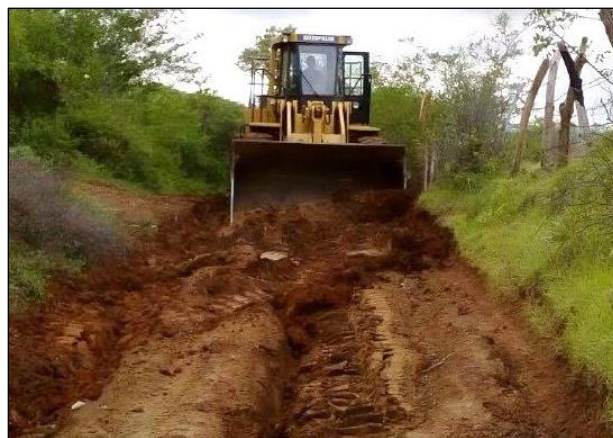
Camino de “Tandinguán” a la localidad de “La Cahuinga” durante su rehabilitación.
