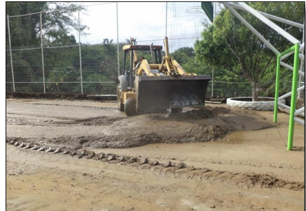
Grandes cantidades de lodo fueron dejadas por la crecida del arroyo junto a la cancha.
