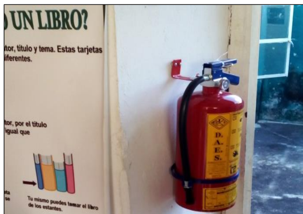
Extintor colocado en la Biblioteca Pública Municipal de la cabecera municipal.
